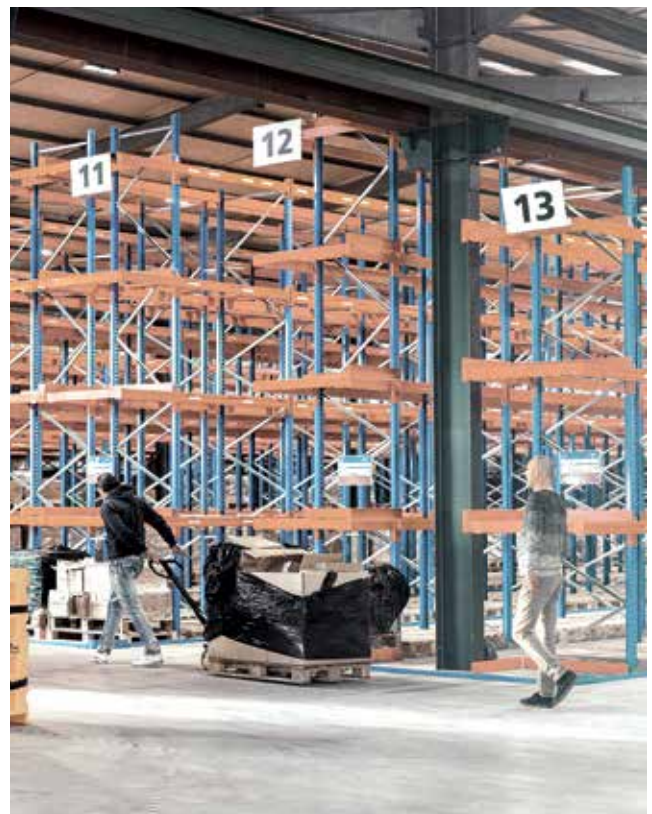
Hala magazynowa RP-Group w Rodgau Optymalizacja oświetlenia i 90% oszczędności energii. Sterowanie oświetlenia podstawowego odbywa się dzięki systemowi CASAMBI.
