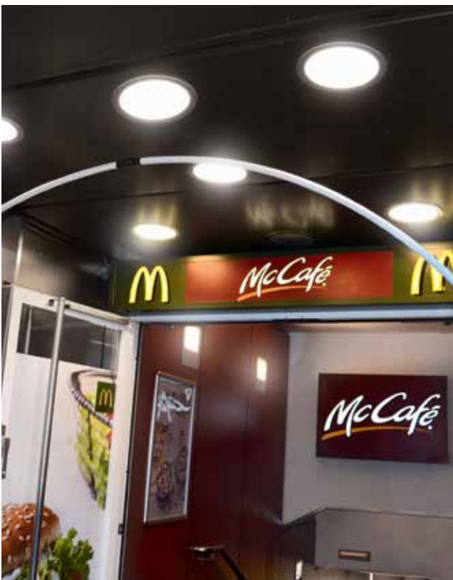
Restauracje McDonald's w Europie W różnych restauracjach McDonald's w Europie niezawodne sufitowe panele LED od RP-Technik dostarczają atrakcyjnego oświetlenia zapewniając niskie koszty eksploatacyjne.
